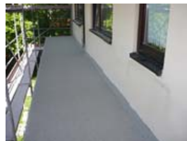
Dauerhaft dicht und zuverlässig vor Brand geschützt präsentieren sich die Balkone nach der Sanierung mit Triflex BFS (S1).
